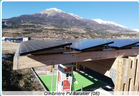
Ombrière PV Baratier (05)
