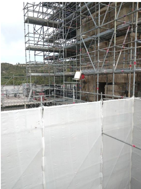
Projecteur de la travée 9 mal orienté
