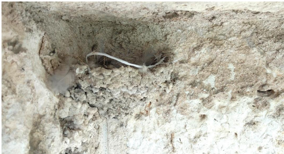
Nid d'Hirondelle de rochers sous l'encorbellement de la pile 9
