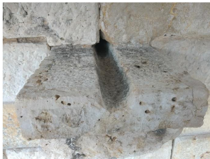
Écoulement d'eau quasiment systématiquement utilisé par le Martinet noir pour nicher
