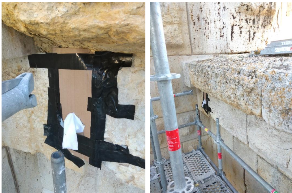
Système anti-retour posé et localisation du gîte vis-à-vis de l'échafaudage et du tablier inférieur
