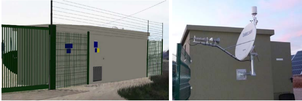
Figure 2. Poste de livraison RAL 7032 (gris silex) et antenne parabolique- © Solairedirect
