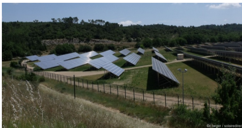
Figure 7. Vue aux points cardinaux de panneaux photovoltaïque et exemple d'un parc. © Solairedirect
