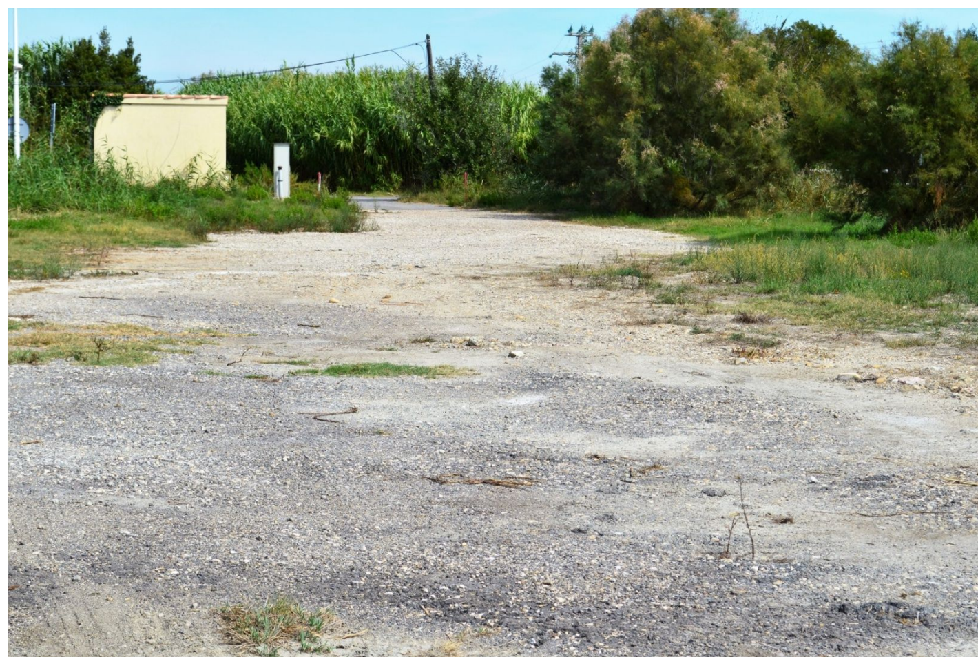
zone dégradé du terrain par des gravas
