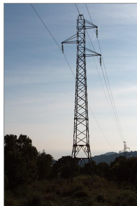
Ligne électrique en partie haute du site
