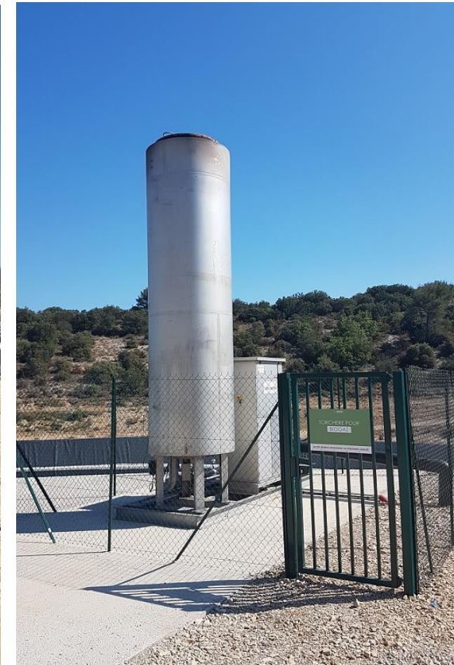
Torchère de brûlage du biogaz
