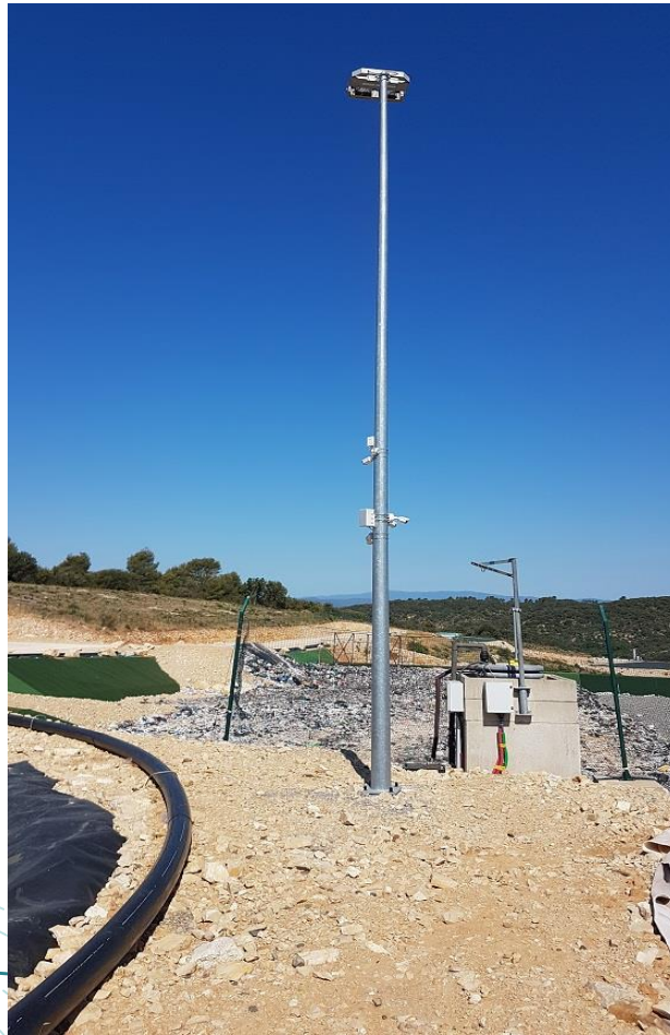
Spot d'éclairage et caméras thermiques
