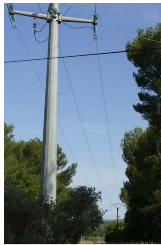
Poteau à haut risque d'électrocution (au premier plan) dans le secteur de Roquefavour © Nicolas FUENTO
