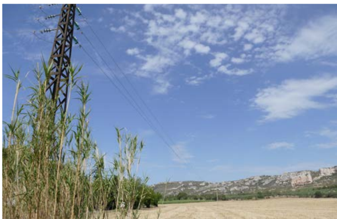
Poteau à haut risque sur le secteur Calissanne/Château Virant © Nicolas FUENTO
