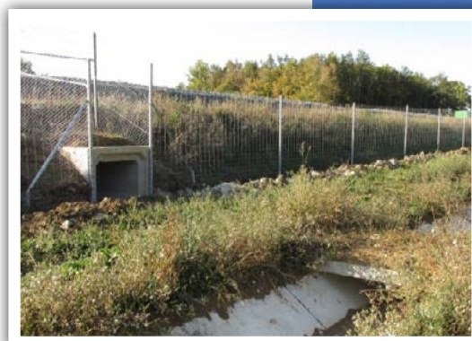
Passage inférieur parfaitement encadré par le grillage permettant de guider la faune vers les entrées © COSEA
