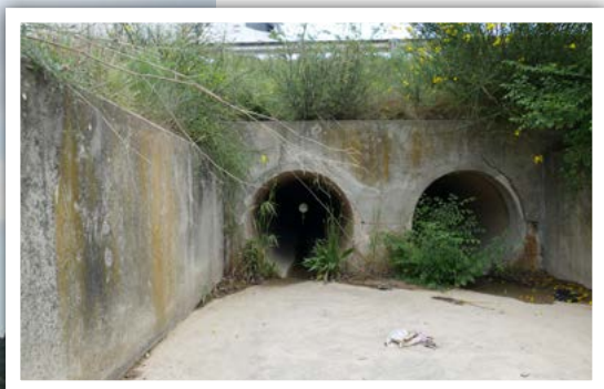
Ouvrage de franchissement à améliorer observé sur l'A7 au PR 242.708 © Nicolas FUENTO
