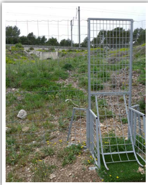
Échappatoire à grande faune au niveau de l'ouvrage ① © Nicolas FUENTO
