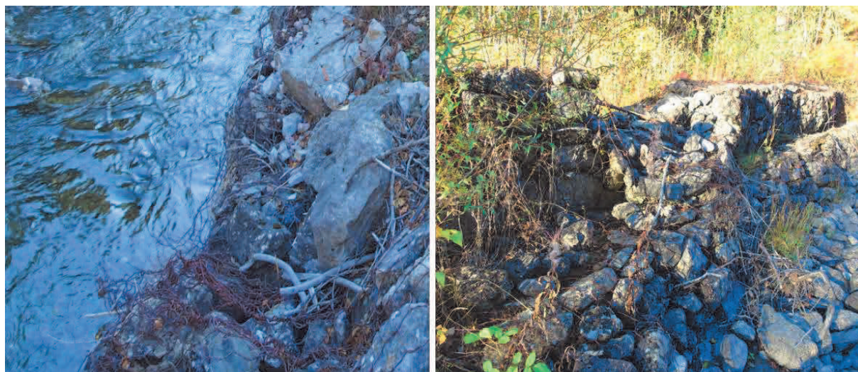
Fig. 75 : exemples de pathologies – tronçon 1 – vidange en pied suite à arrachement des gabions (à gauche) et basculement de la partie haute des gabions (à droite)
