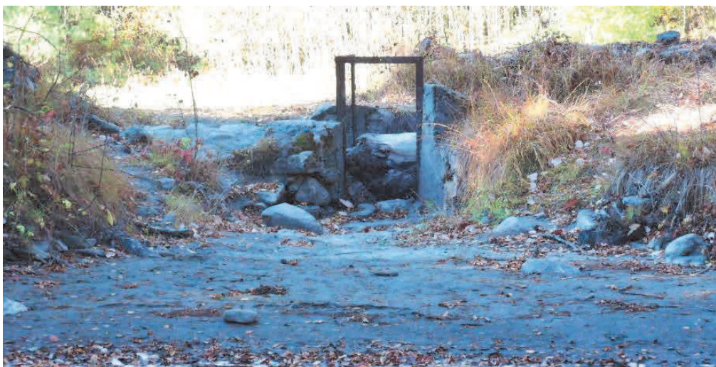
Fig. 46 : photos de la prise d'eau – aperçu du point bas créé par cet ouvrage – point critique
