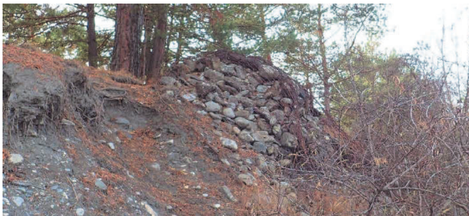
Fig. 71 : exemple de rupture de gabion par érosion puis basculement en pied d'ouvrage (digue de l'Ubaye à Barcelonnette, ONF-RTM04)
