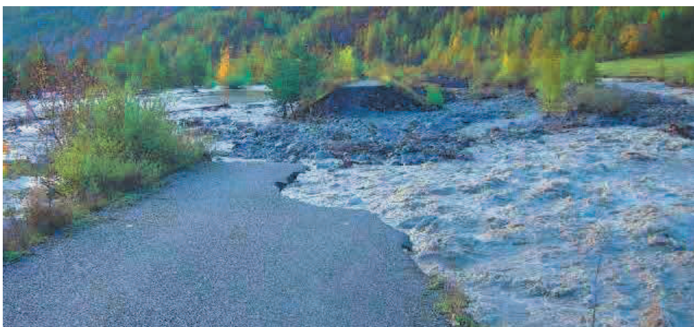
Fig. 73 : exemple de rupture d'une digue en remblai par érosion externe (digue du torrent de Réallon, ONF-RTM05)
