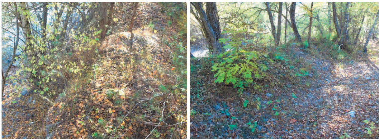
Fig. 79 : exemples de pathologies – tronçon 5 – point bas et irrégularité de la crête (à gauche) et crête étroite et présence d'arbres sur l'ouvrage (à droite)
