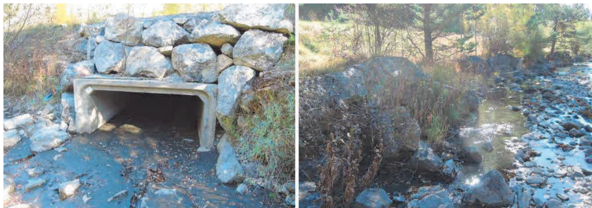
Fig. 44 : photos du dalot de retour des écoulements de la plaine rive gauche (à gauche) et de la berge rive gauche protégée par des enrochements secs disposés en vrac (tronçon 6)
