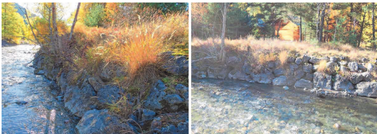
Fig. 77 : exemples de pathologies – tronçon 3 – arbres en bosquet présents au pied de la digue (à gauche) et espacement entre les blocs (à droite)
