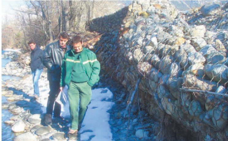
Fig. 72 : exemple de rupture de gabions érosion puis par basculement (digue de la Durance à la Roche de Rame, ONF-RTM05)
