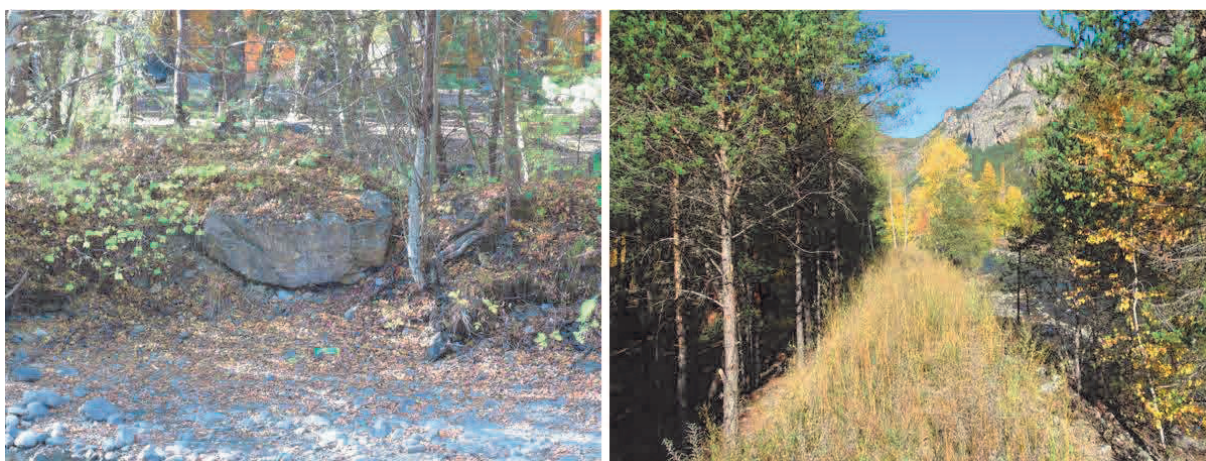
Fig. 78 : exemples de pathologies – tronçon 4 – point bas sur l'extrême partie aval de la digue (à gauche) et crête étroite de l'ouvrage (à droite)
