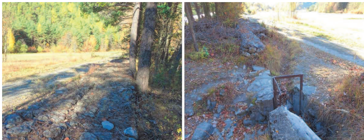
Fig. 76 : exemples de pathologies – tronçon 2 – arbres de gros diamètres présents au pied de la digue (à gauche) et point bas au niveau de la prise d'eau (à droite)
