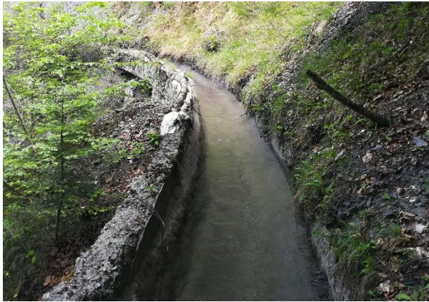
Zone à conforter
