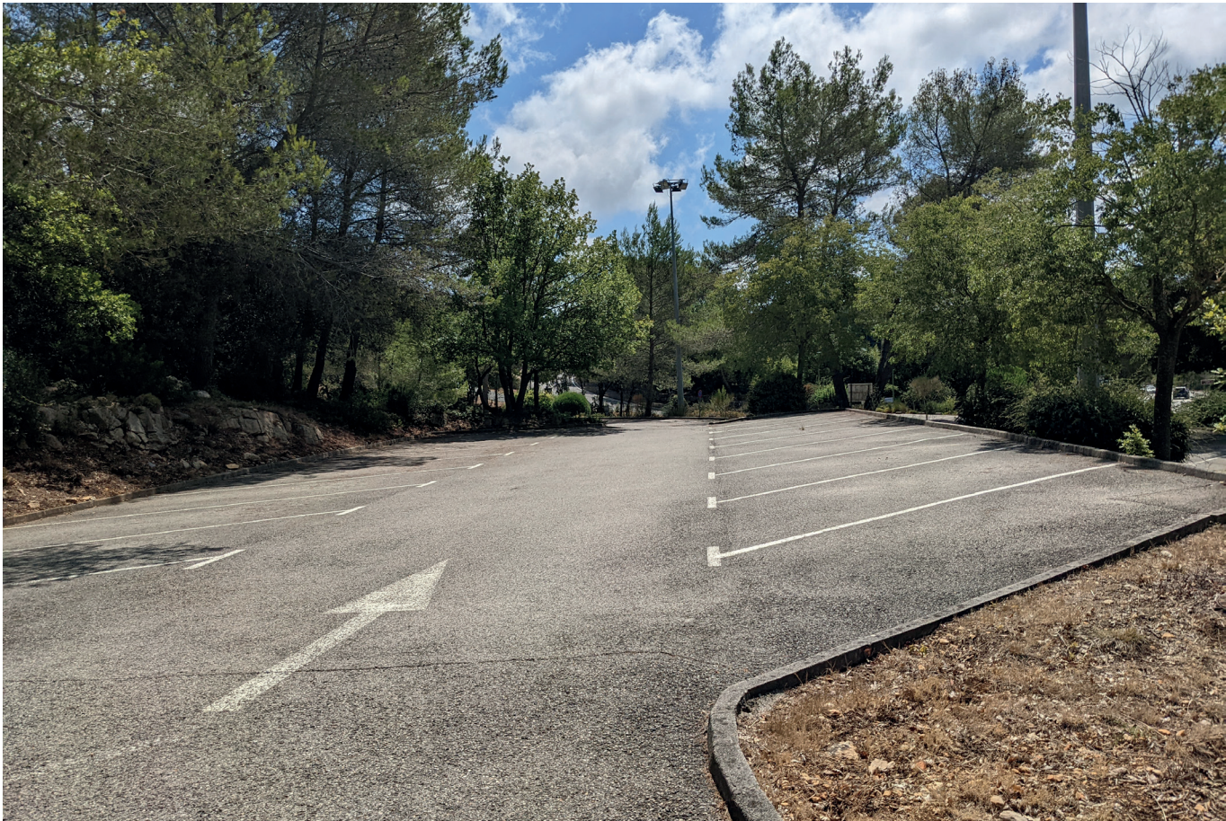
V1. Photographie de l'existant. Enrobé du parking.
