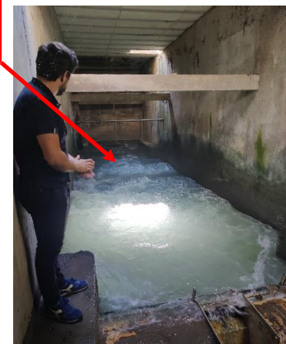
Photographie intérieur chambre de répartition
