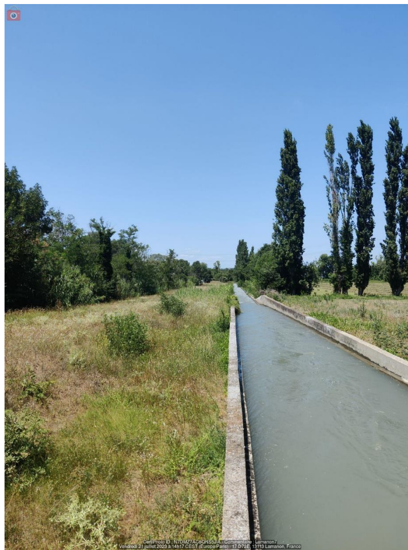
Photo 6 : Vue complète du coursier et de la berge vers l'aval
