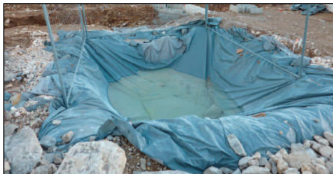
Exemples de fosses étanches de récupération des résidus de nettoyage des goulottes des toupies béton
