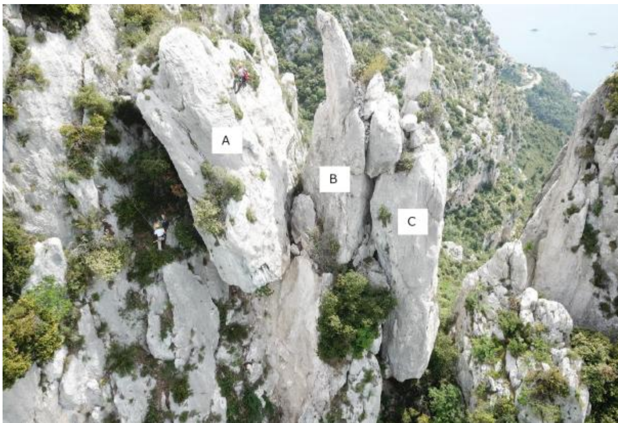
Figure 4: Masses devant faire l'objet d'une purge par minage (côté Ouest)
