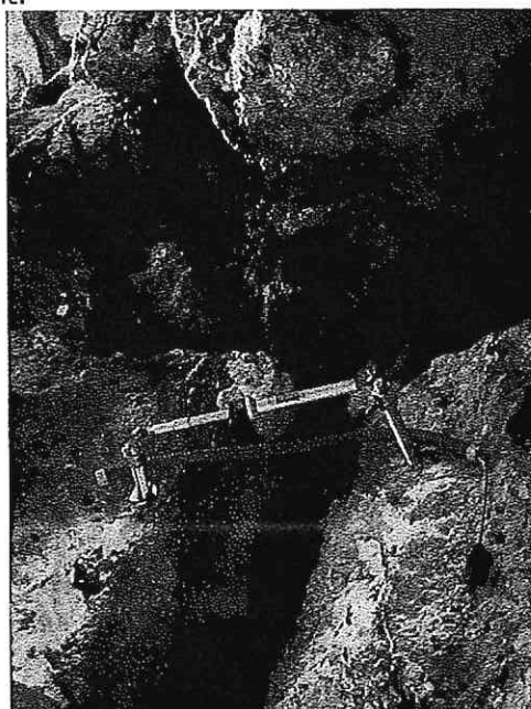
Exemple d'extensomètre base courte à mettre en place en surveillance permanente
