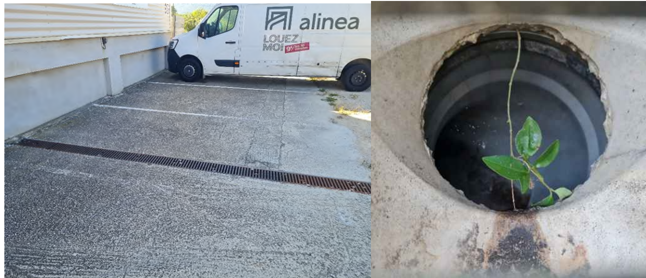
Figure 7 : Caniveau grille à l'Ouest du bâtiment et son exutoire
