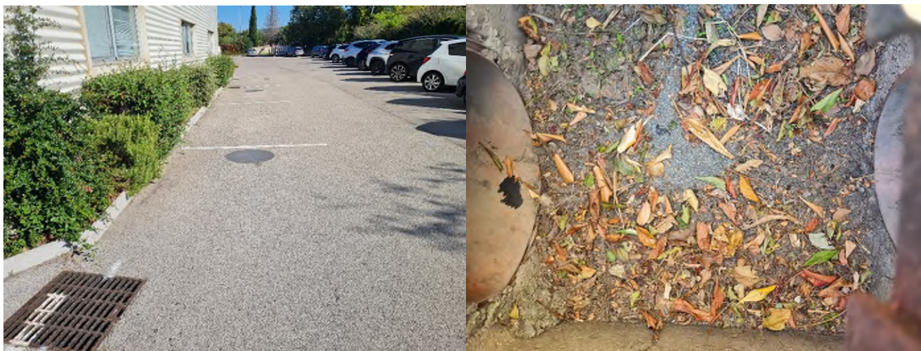
Figure 8 : Grilles de la canalisation exutoire de la partie Est du bâtiment (à gauche) et vue dans une grille de cette canalisation en D300 mm (à droite)
