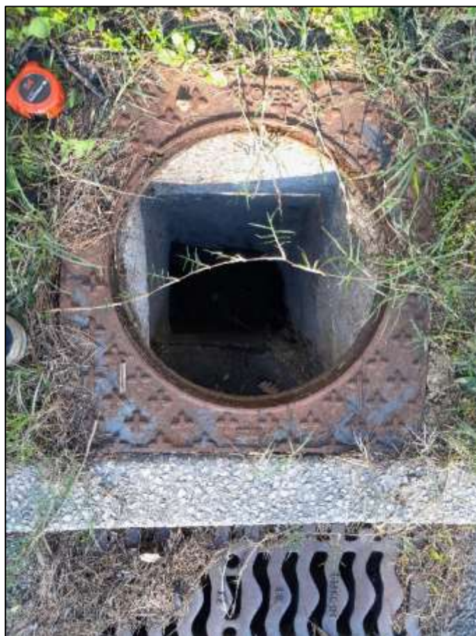
Photographie 1 : Grille avaloir et regard donnant sur le réseau communal Ø 400 mm
