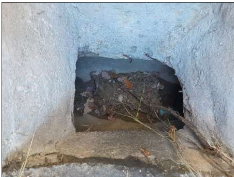
Photographie 2 : Réseau pluvial communal Ø 400 mm
