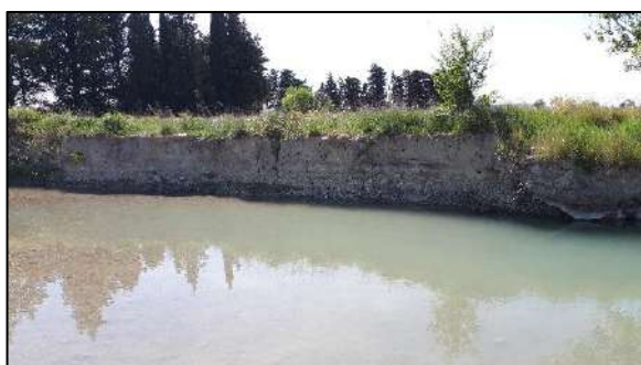
Front d'érosion en aval des enrochements
