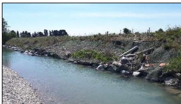
Absence de végétation rivulaire sur les enrochements
