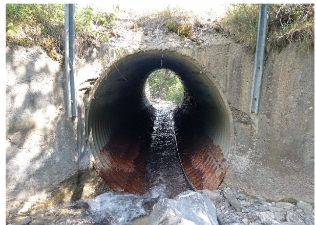
Buse permettant la traversée du Rioclar sous la route qui mène au centre de vacances
