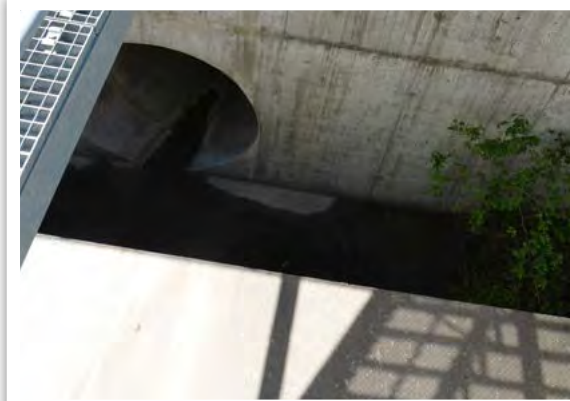
Ouvrage n°29 Buse en sortie de bassin de rétention © LPO PACA
