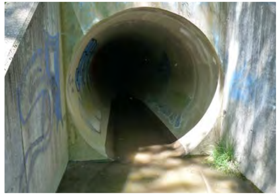
Aval ouvrage n°34 à retravailler afin que l'eau ne stagne pas © LPO PACA
