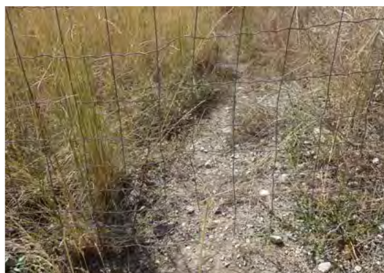
Traces de passage d'animaux sous les clôtures entourant l'ouvrage n°16 © LPO PACA
