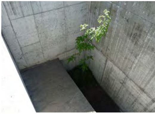
Ouvrage n°29 Bassin béton piège potentiel pour la faune © LPO PACA
