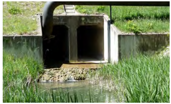
Ouvrage n°35 aval à retravailler afin de l'eau ne stagne pas © LPO PACA
