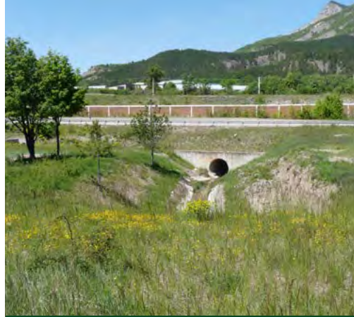
Buse sous la RD 942 © LPO PACA
