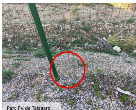
Parc PV de Talagard Trouée réalisée pour la perméabilité des parcs.
